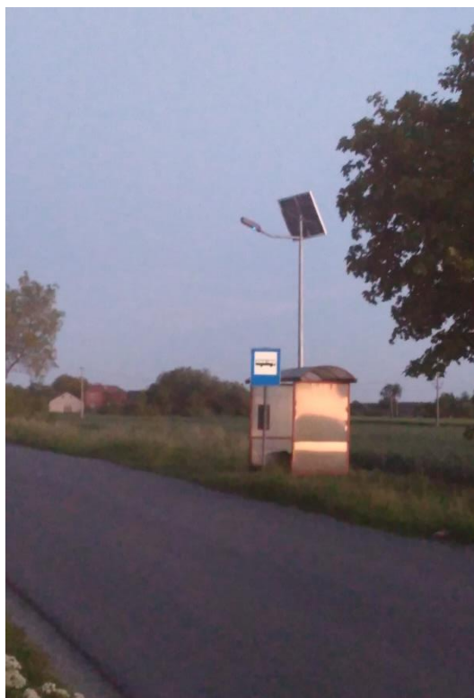
Oświetlenie uliczne solarne w miejscowości Stara Biała
